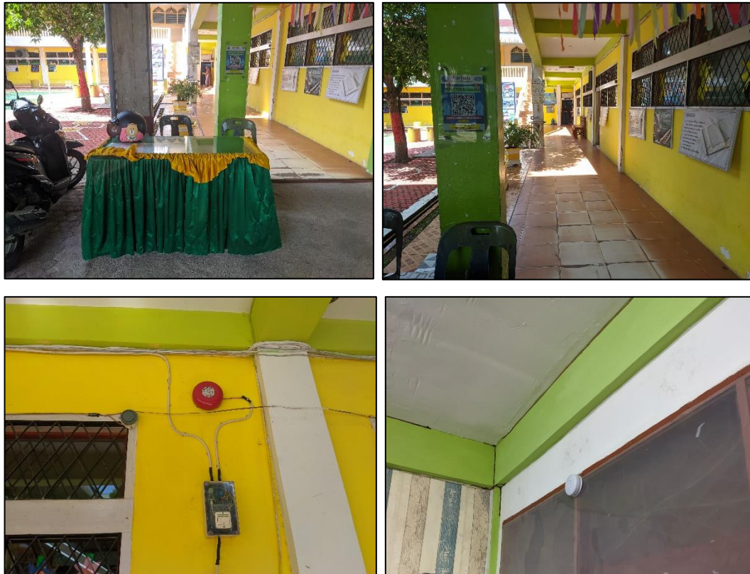
Gambar 4.18 Letak meja petugas jaga dan detector kebakaran Sumber: Dokumentasi lapangan (2024).
