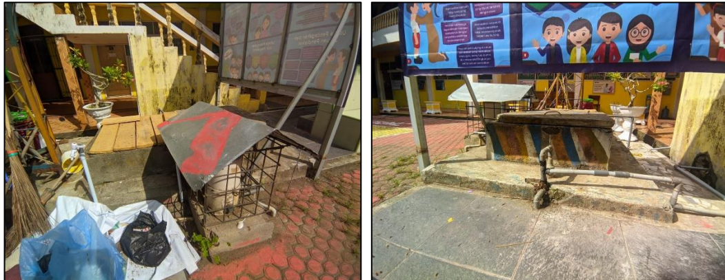
Gambar 4.17 Letak pompa dan pipa air Sumber: Dokumentasi lapangan (2024).
