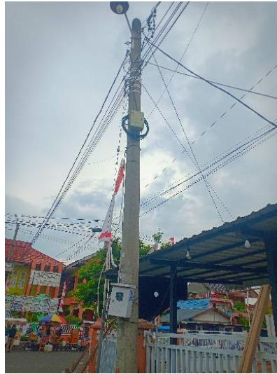
Gambar 4. 12 Suplai listrik pada lokasi pedagang (Dokumentasi penulis, 2023)
