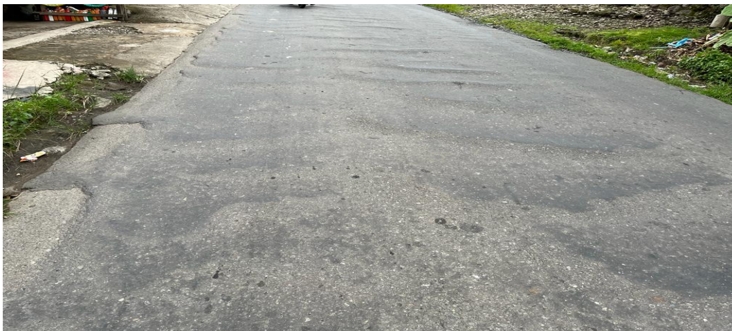
Gambar 4.5 Kerusakan Bergelombang Pada Peverasan Lentur (Peneliti)
