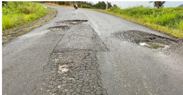
Gambar 1.2 Kerusakan Jalan KKA Pada Km 44,7 (Sumber: Dokumentasi Pribadi)
